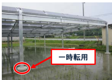
▲ 営農型太陽光発電設備の例
